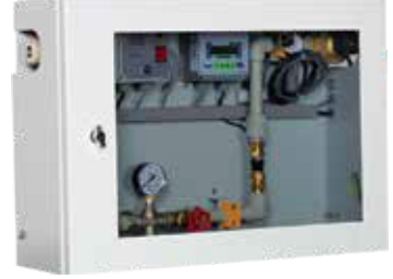
DEBİMETRE (Dolap) Flowmeter منظومة الماء للمرطبة
